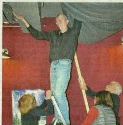
Decken und Wände werden mit Molton-Stoffen ausgekleidet, die Licht und Schall absorbieren.
